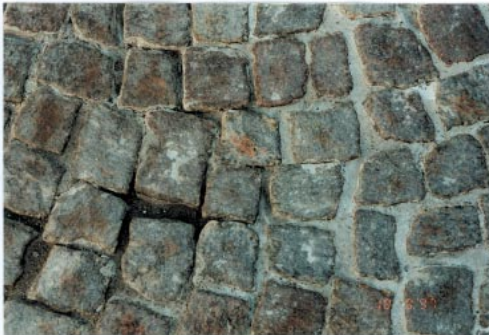
Herkömmlicher Fugenmörtel Fugenvertiefungen durch „Nachsitzen“ des Fugenmörtels.
