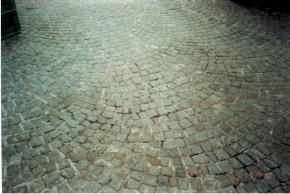
Fläche mit herkömmlichen Fugenmörtel
