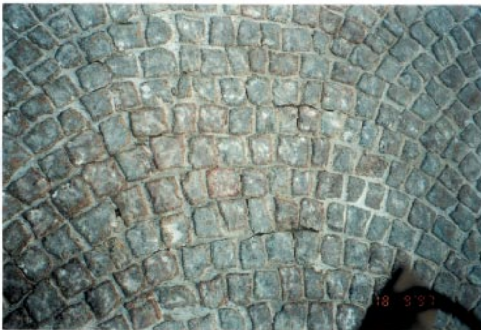
Herkömmliche Fugenmasse. Risse entlang der Steinflanken.
